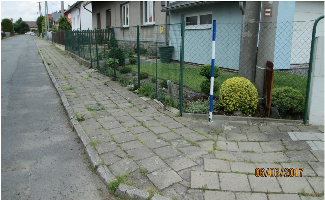
Stav chodníků před rekonstrukcí...
